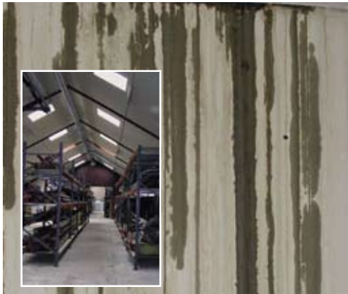
Ombygget hal, som bruges til magasin. En utæthed i taget gør, at der render vand ned af væggen. Ved tætning af taget og maling af betongulvet kunne det blive et godt magasin.
