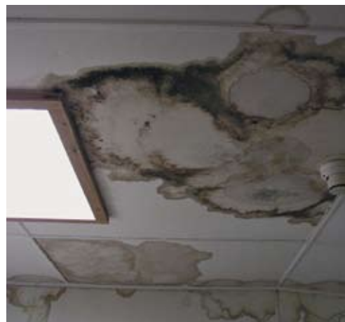
Utætte lofter og mure i museumsmagasiner er med til at ødelægge indeklimaet i et magasin.
