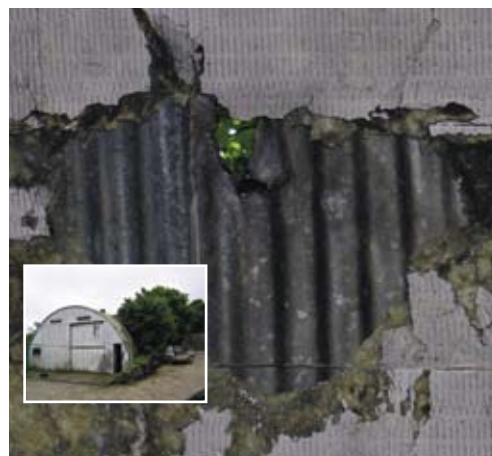
Gennemgående hul i magasinets ydervæg.
