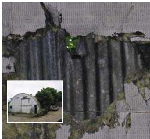
Gennemgående hul i magasinets ydervæg.
