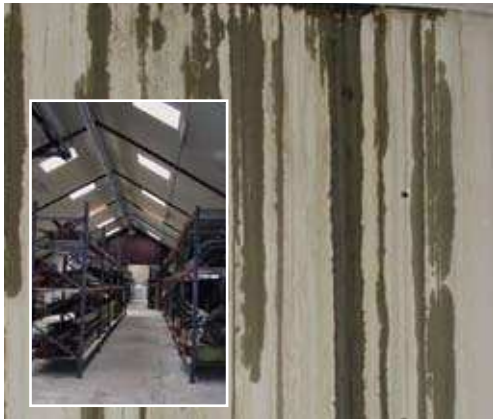
Ombygget hal, som bruges til magasin. En utæthed i taget gør, at der render vand ned af væggen. Ved tætning af taget og maling af betongulvet kunne det blive et godt magasin.
