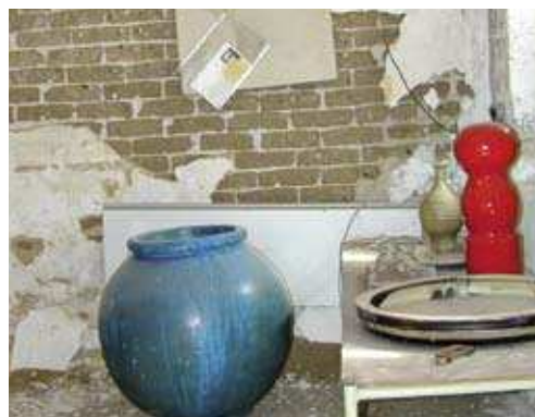
Ved skiftende eller forkert luftfugtighed, kan blandt andet puds og fuger ødelægges.
